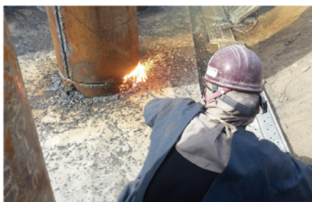
4. 鋼管杭の熔断
